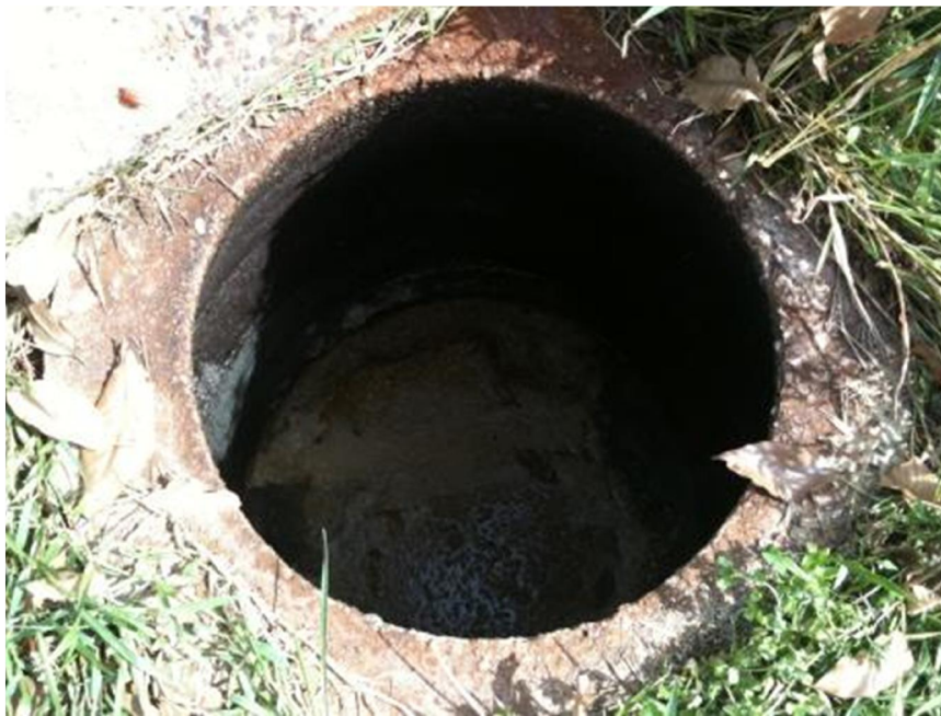
Figura 2. Caixa de entrada da ETE incrustada de gordura (o Autor, 2012).
