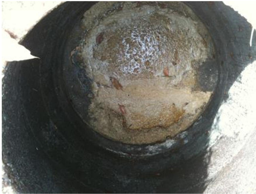
Figura 3. Detalhe para incrustações de gordura na caixa (o Autor, 2012).
