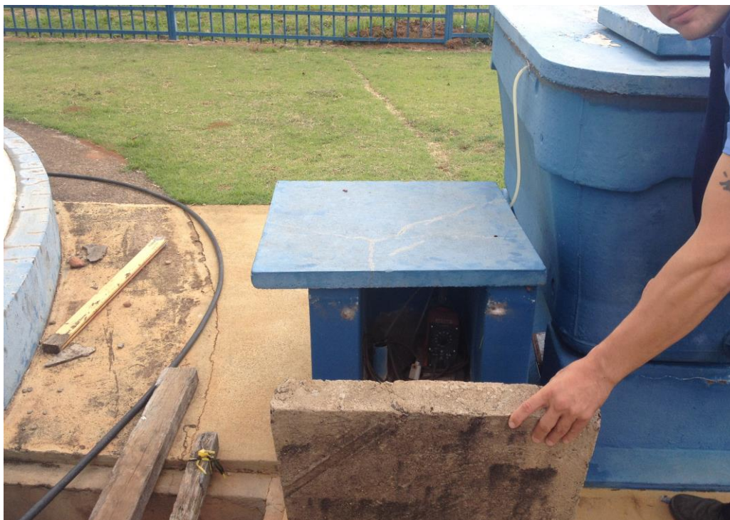
Figura 5 - Tanque de cloração e bomba dosadora Data: Junho 2014
