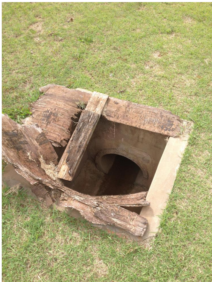
Figura 10 - Caixa de escoamento de água pluvial Data: Junho de 2014
