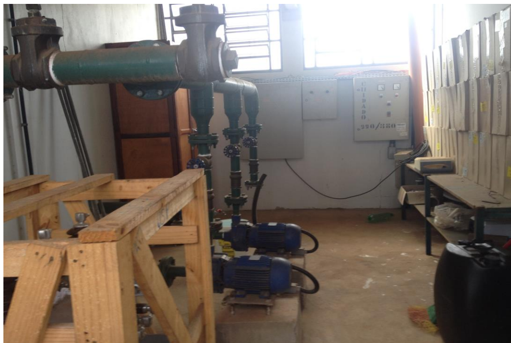
Figura 6 - Casa de bombas Data: Junho de 2014
