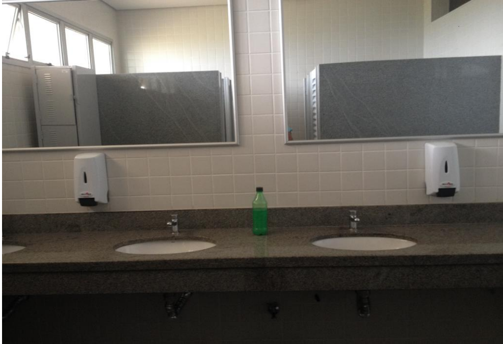
Figura 7 - Banheiro do prédio de Engenharia de Materiais
