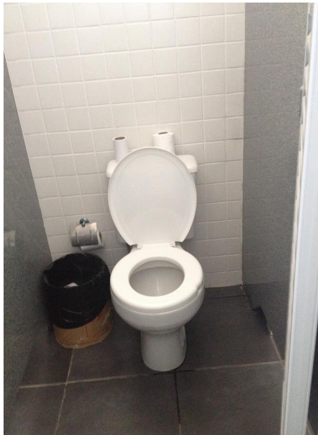
Figura 8 - Privada acoplada do prédio da Engenharia de Materiais da área 2
