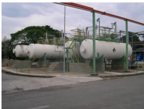
DEPÓSITO DE BUTADIENO
