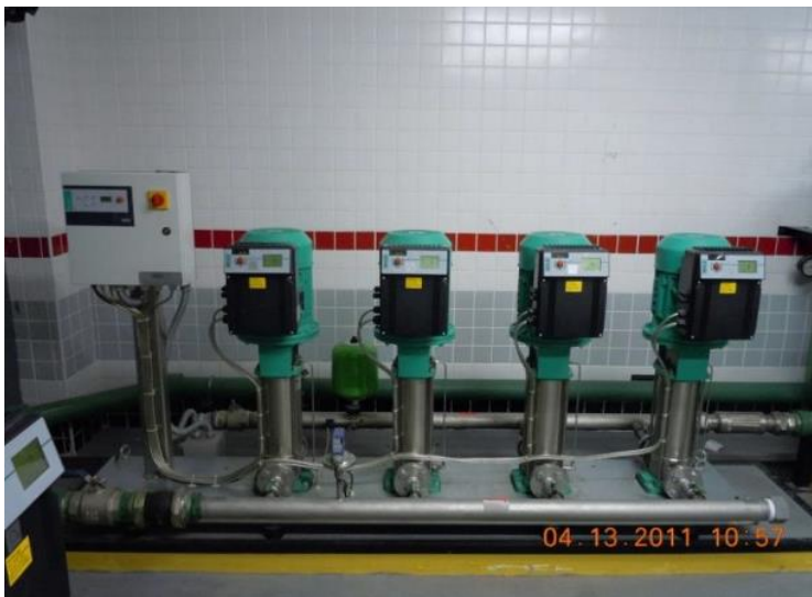
Associação de bombas de uma zona de pressão
