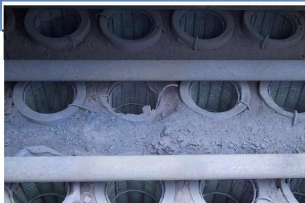
Mangas furadas e deposição de pó na área limpa
