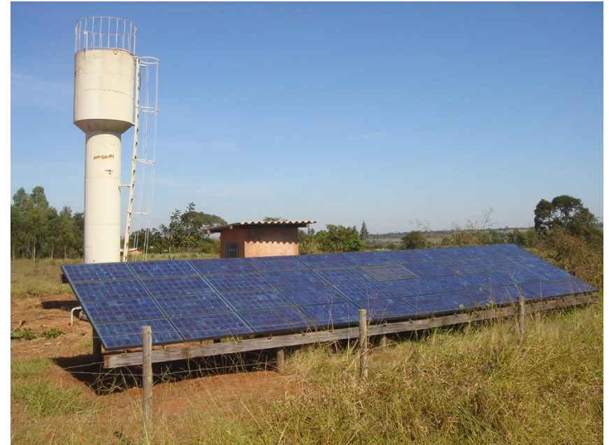
Bombeamento, Projeto LSF-IEE, ITESP, Presidente Bernardes, SP Bomba e acondicionamento de potência de fabricação nacional
