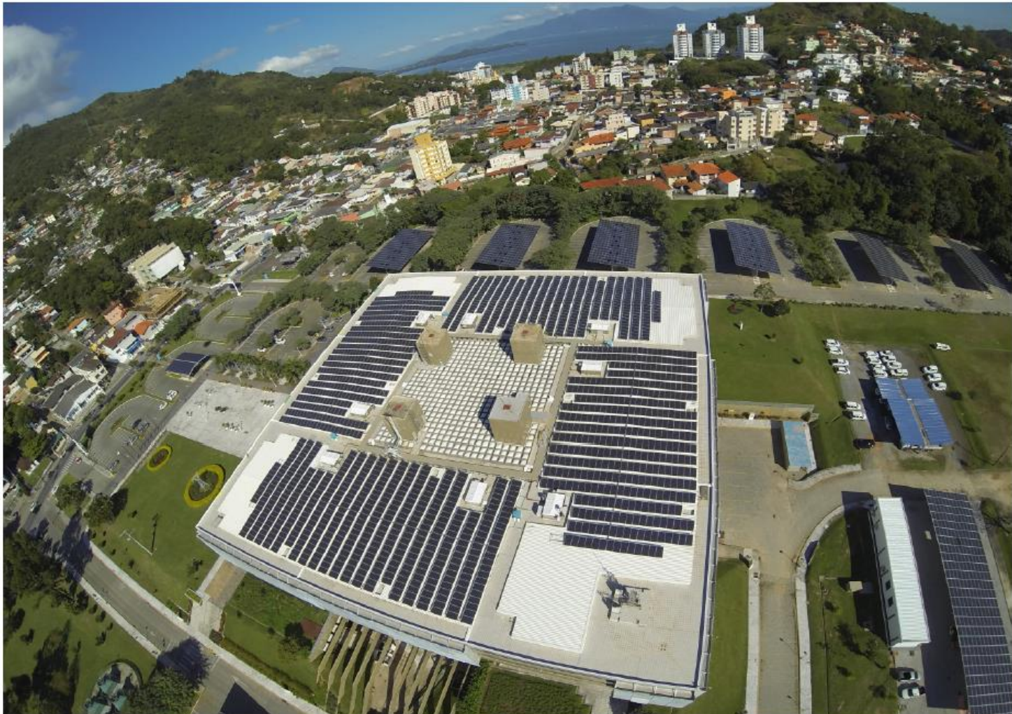
Megawatt Solar: 1,1 MWp instalado sobre a cobertura do Edifício Sede da Eletrosul e de estacionamentos, instalado na cidade de Florianópolis, SC (UFSC;2014).
