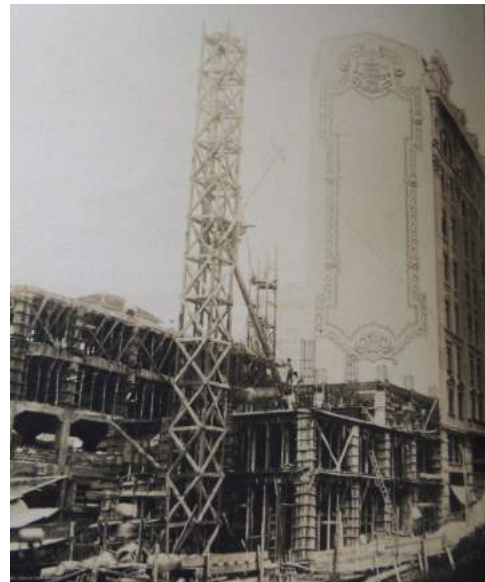
Fig.117 Em primeiro plano o canteiro de obras do edifício Condessa Siciliano (concluído em 1924), em segundo plano o Casa Palmares (concluído em 1922) e, ao fundo, o London & River Plate Bank com nome inscrito na empena lateral como o vizinho. Acervo Siciliano & Silva. GONZALEZ et al., 2012, p.122-123.
