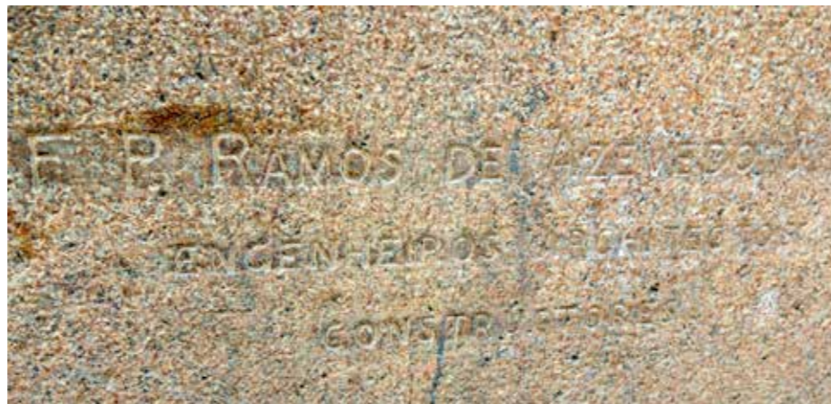
Fig.352 Epígrafe estampada na fachada do Edifício Lutétia do Escritório F. P. Ramos de Azevedo & Cia , responsável pelo projeto.
