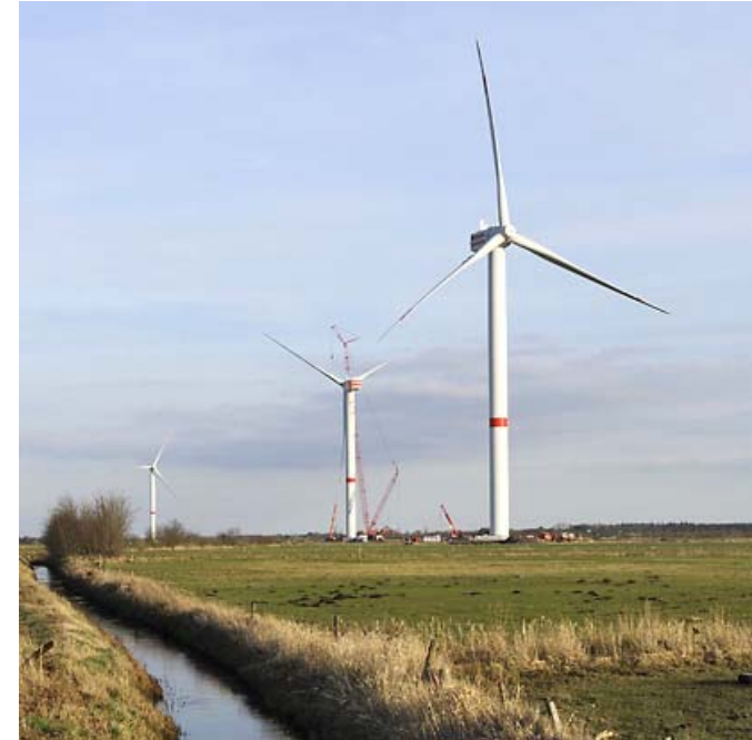
Turbinas de 6.000 kW da REpower (fronteira Alemanha-Dinamarca março/2009)
