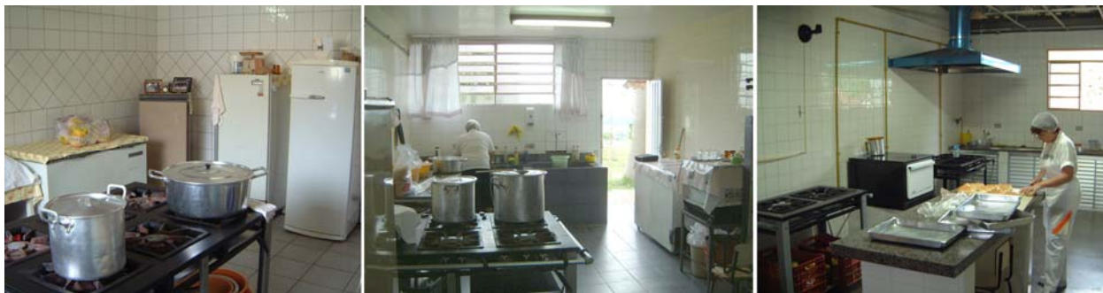
Figura 32. Fornos e fogões próximos a refrigeradores e pias
