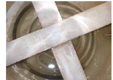
Resistência coberta por água e suporte da cesta
