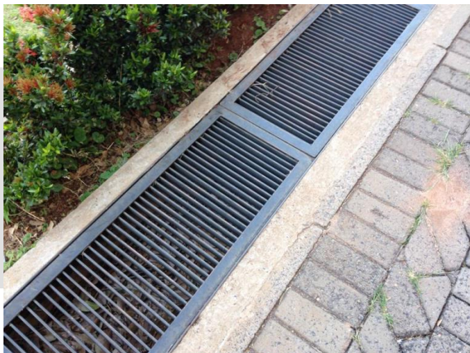
Canaletas coletoras com grelha - área externa da edificação. Maio 2014
