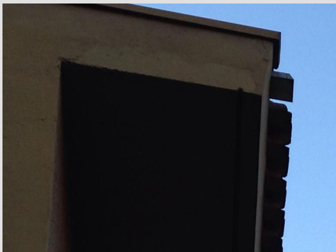
Beiral visto do pavimento térreo - água direcionada às áreas permeáveis da edificação. Maio 2014
