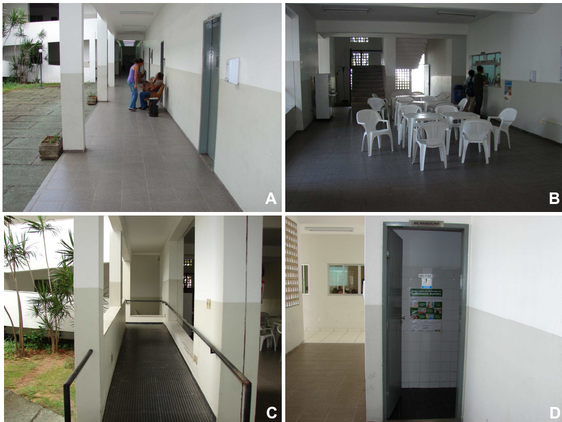
FIGURA 5 – A imagem A retrata um dos corredores, a imagem B a cantina da escola, a imagem C uma das rampas de acesso à cadeirantes e a imagem D a entrada de um dos banheiros masculinos, evidenciando ausência de placa indicativa em Braille.
