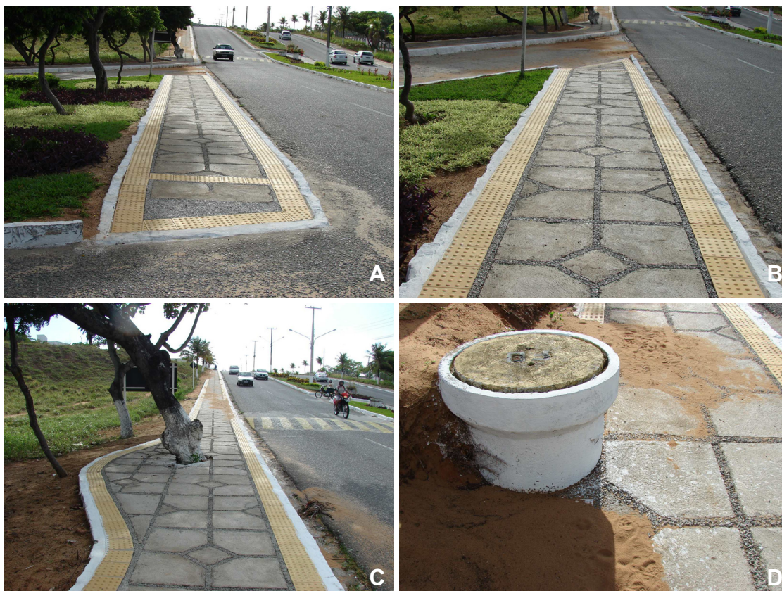
FIGURA 3 – Acesso a EMUFRN. Rebaixamento de calçada não correspondido ao se atravessar à rua, barreiras ambientais e arquitetônicas sem a devida sinalização.
