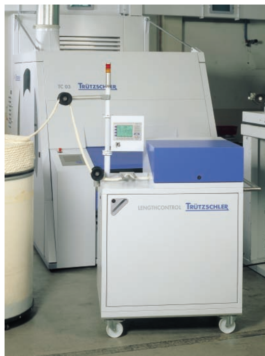
O equipamento de medição é transportável sobre rodas no interior da fiação
