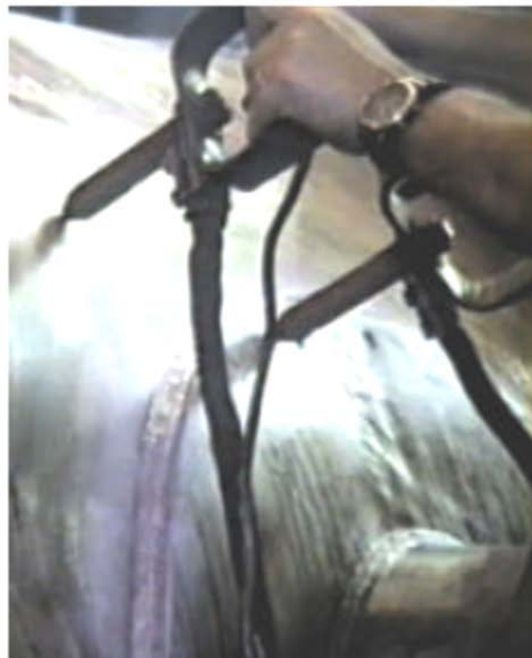
Uso da técnica de eletrodos para inspeção de uma solda de conexão
