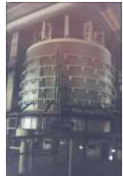
Decantador "Dorr" com tomadas externas de caldo
