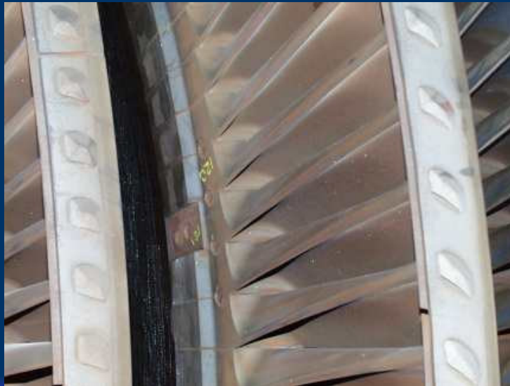
Turbinas a Vapor
