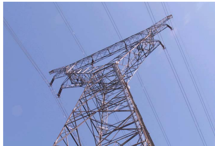
Sistemas HVAC e HVDC
