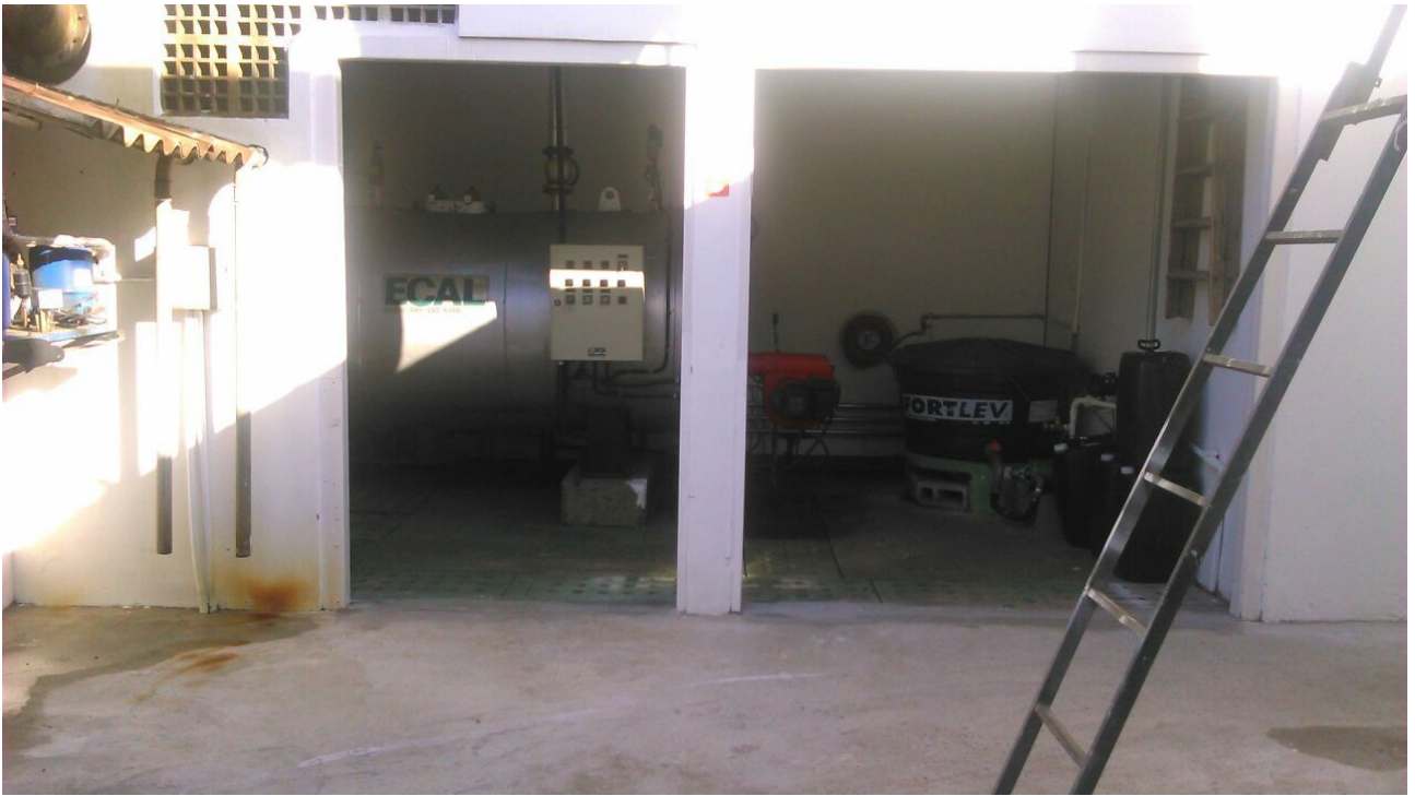
Figura 9: Caldeiras e bomba d'água.
