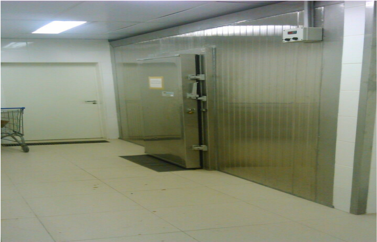
Figura 11: Sistema de refrigeração.
