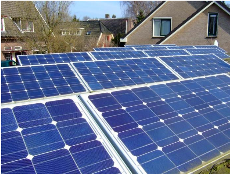
Imagem dos painéis solares
