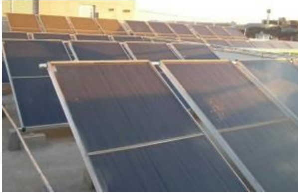
Imagem painéis de aquecimento solar
