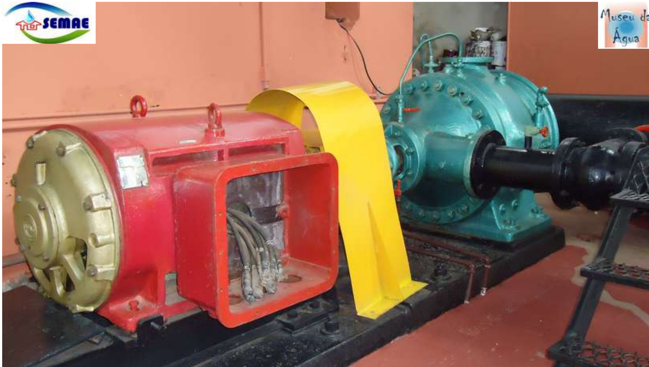
Vista do conjunto desativado de motobomba elétrica, acoplada à uma bomba d'água.
