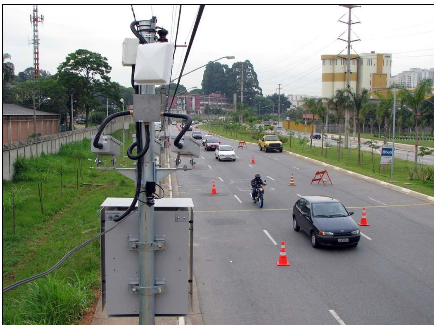
Figura 11 – Equipamentos em testes na Av. Escola Politécnica
