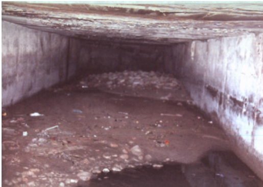
Canalização assoreada do Córrego Uberaba, sob a Avenida dos Bandeirantes, São Paulo, 1996
