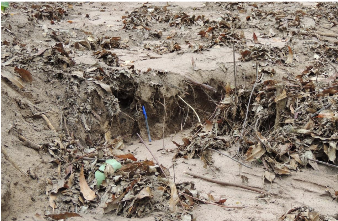
Figura 5.20 – Buraco formado na estrada, dentro da plantação de eucalipto: comparativo.
