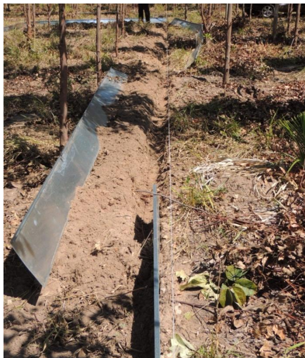
Figura 4.8 – Abertura da vala e colocação das chapas metálicas laterais e de fundo.
