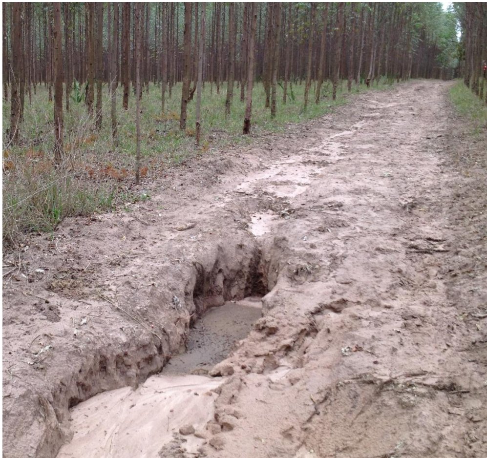
Figura 5.19 – Buraco na estrada causado pela enxurrada.
