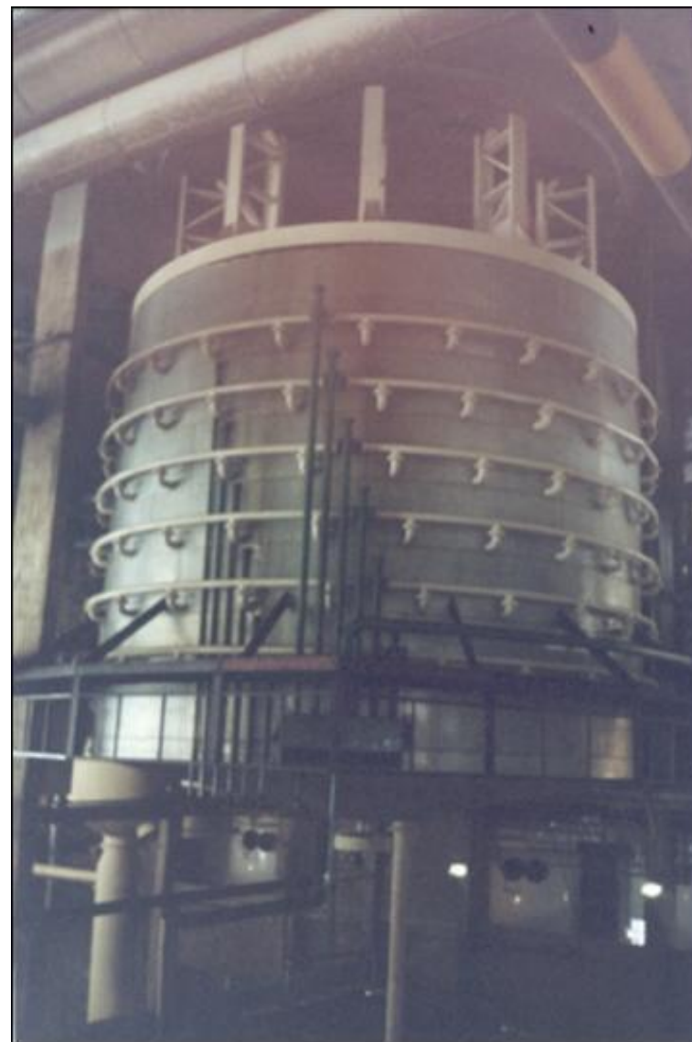
Decantador "Door" com tomadas externas de caldo
