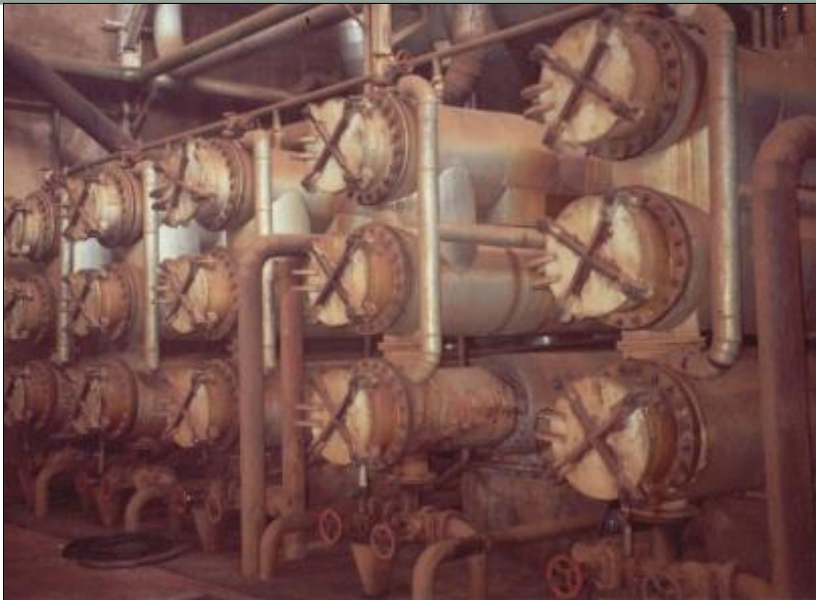
Bateria de aquecedores horizontais
