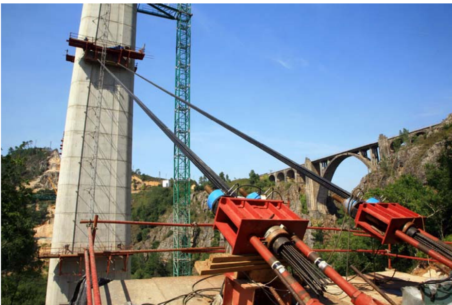
Figura 19. Anclajes activos de retenida
