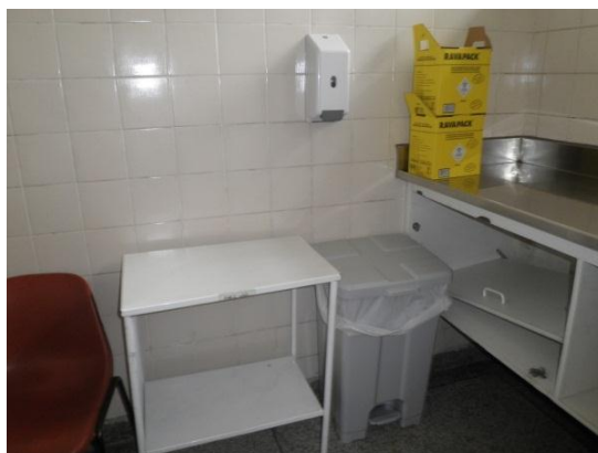
Figura 12 - Caixas de perfurocortantes indevidamente localizadas sobre pia da sala de coleta de exames laboratoriais da UBS-A, fev./2012
