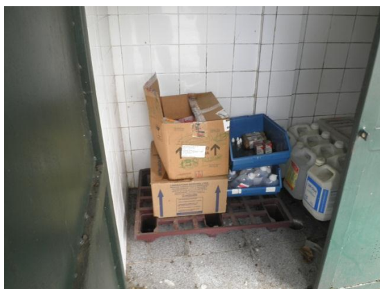
Figura 26 - Abrigo de resíduos químicos da UBS-A, fev./2012
