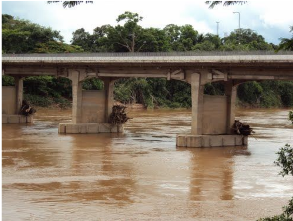
Imagem 1 - Ponte onde ocorreu o acidente
