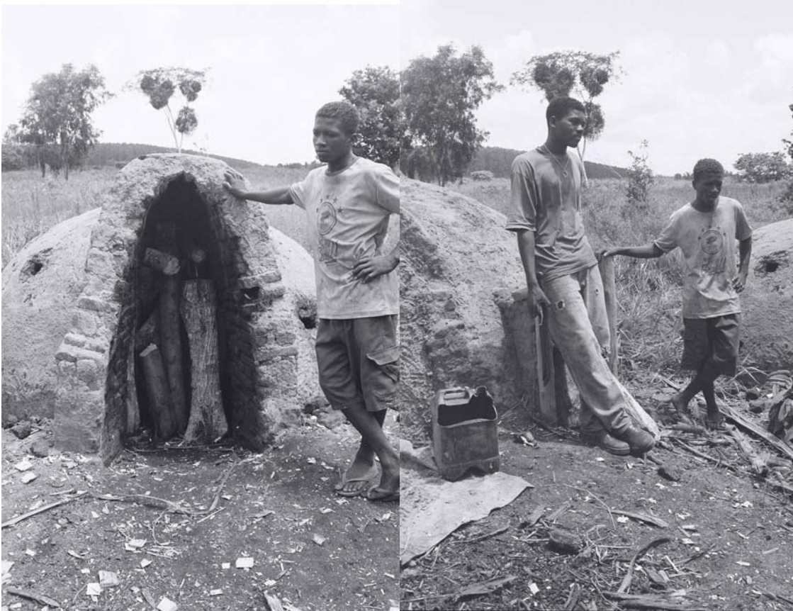
Jones mostrando o forno cheio de facho e Renato e Jones junto aos fornos que eles mesmos construíram
