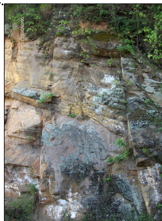
Figura 5-17: Fraturas subverticais em arenito da Formação Pirambóia. Autor: PINHEIRO, M. R. Data: 06/05/2012.
