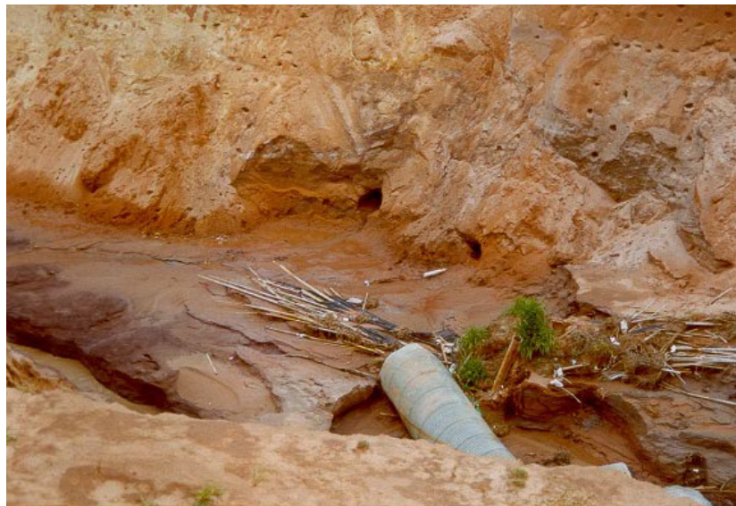
Figura 5.34- observar a tubulação de águas pluviais totalmente destruída, no canal do Dimas em Dezembro de 2000.
