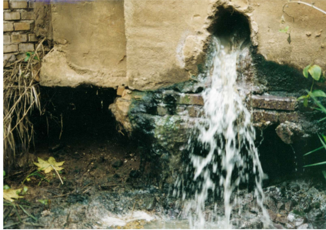
Figura 6.8- Colapso das obras de controle de microdrenagem, que depois são reconstruídas.
