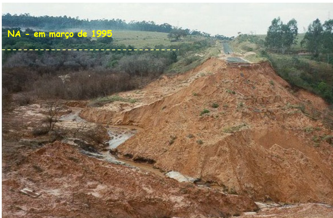
Figura 5.3- Com as chuvas de Março de 1995, o nível do córrego do Tucum subiu formando uma represa, que acabou rompendo o aterro sobre qual passava a SP-191 (Pejon e Zuquette, 2001).
