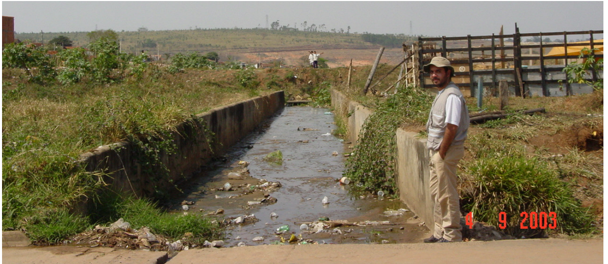
Figura 5.32- observar a canaleta construída no início do canal do Dimas, observar que esta acaba levando lixo para a rede de águas pluviais.
