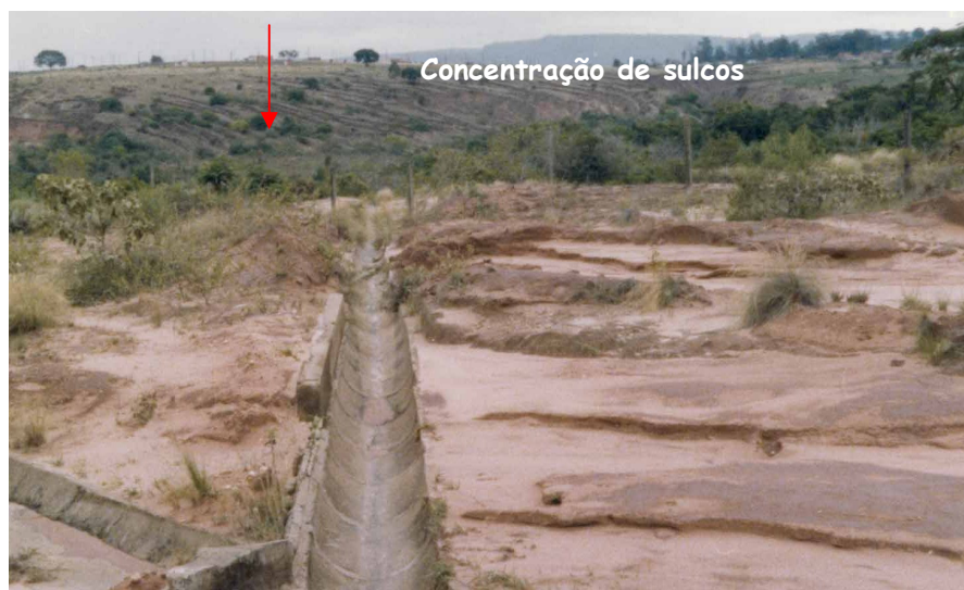
Figura 5.1 - Vista da encosta do loteamento Recanto das Águas em 1980, observar que ela esta completamente sulcada, com indicado pela seta (Oka-Fiori,1980).
