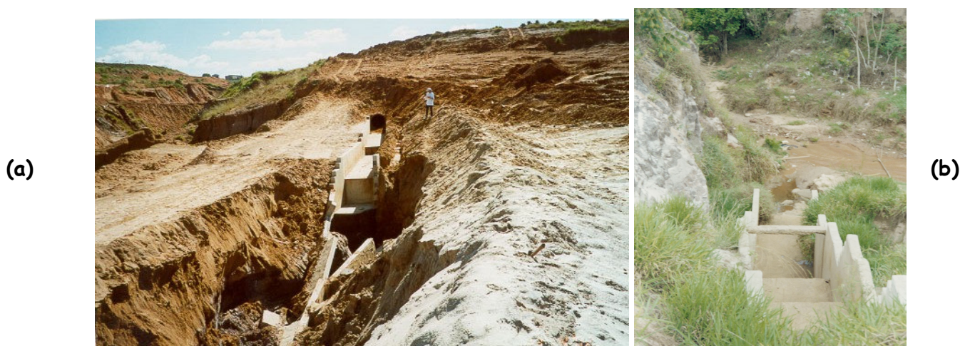
Figura 5.37- Mostra a escada dissipadora da margem esquerda do Dimas rompida no inverno de 2002 (a) e depois de reconstruída (b).
