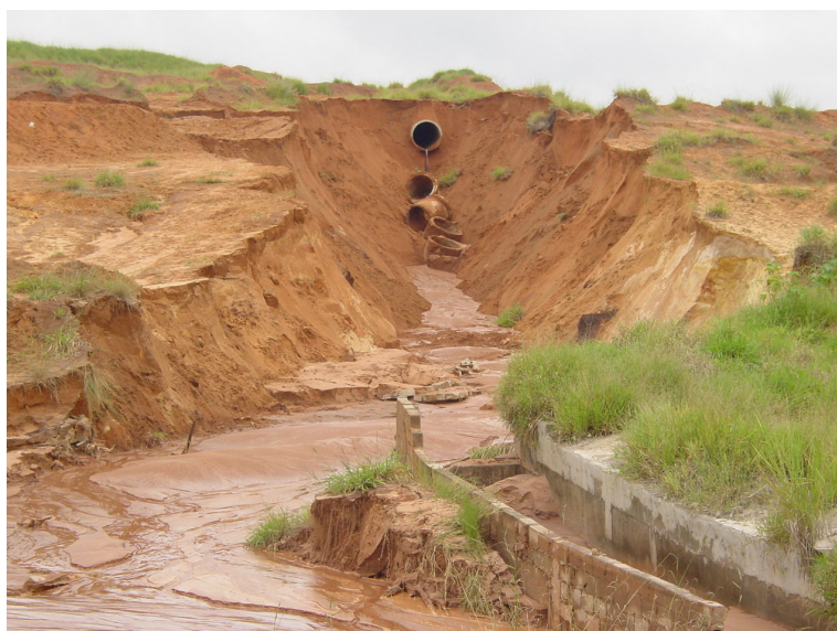
Figura 5.7- Nesta foto observa-se a nova voçoroca formada pelo rompimento da obras de águas pluviais.
