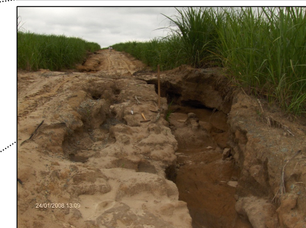
Foto 2-9: Sulco em estrada de acesso à canalial.
