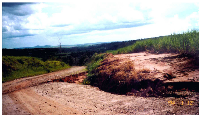
Figura 13 - Feição erosiva em estrada Rt02.
