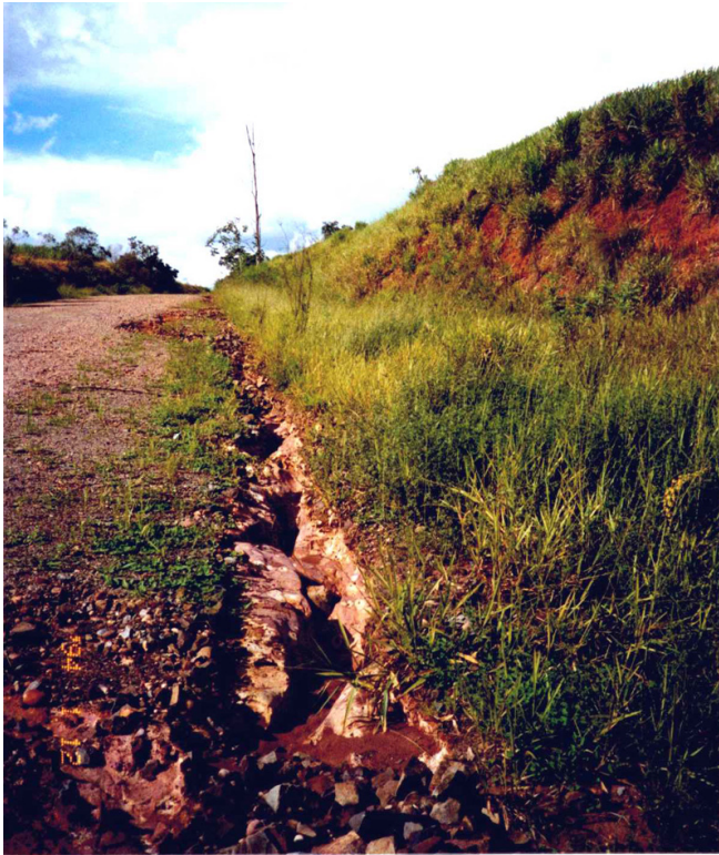
Figura 14 - Feição erosiva na estrada vicinal em rocha pouco alterada.
