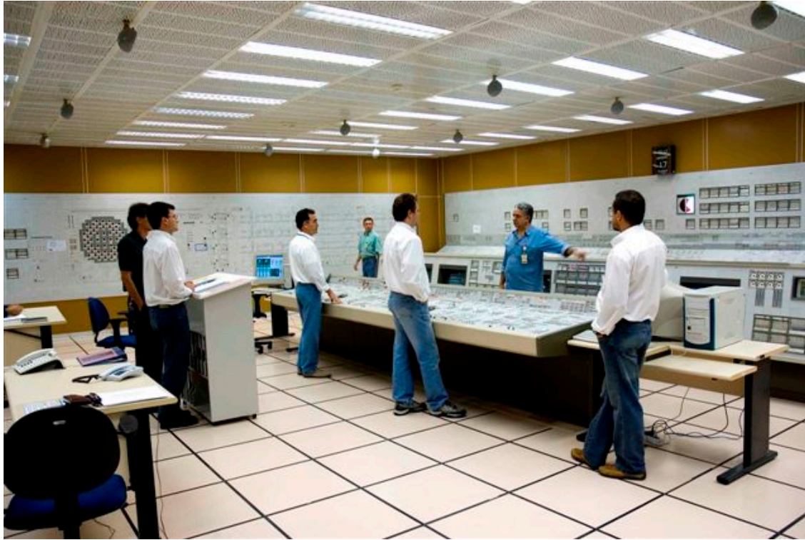
Simulador da Sala de Controle de uma Usina Nuclear (Eletronuclear)
