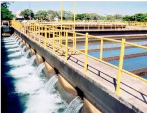
Estação de tratamento
