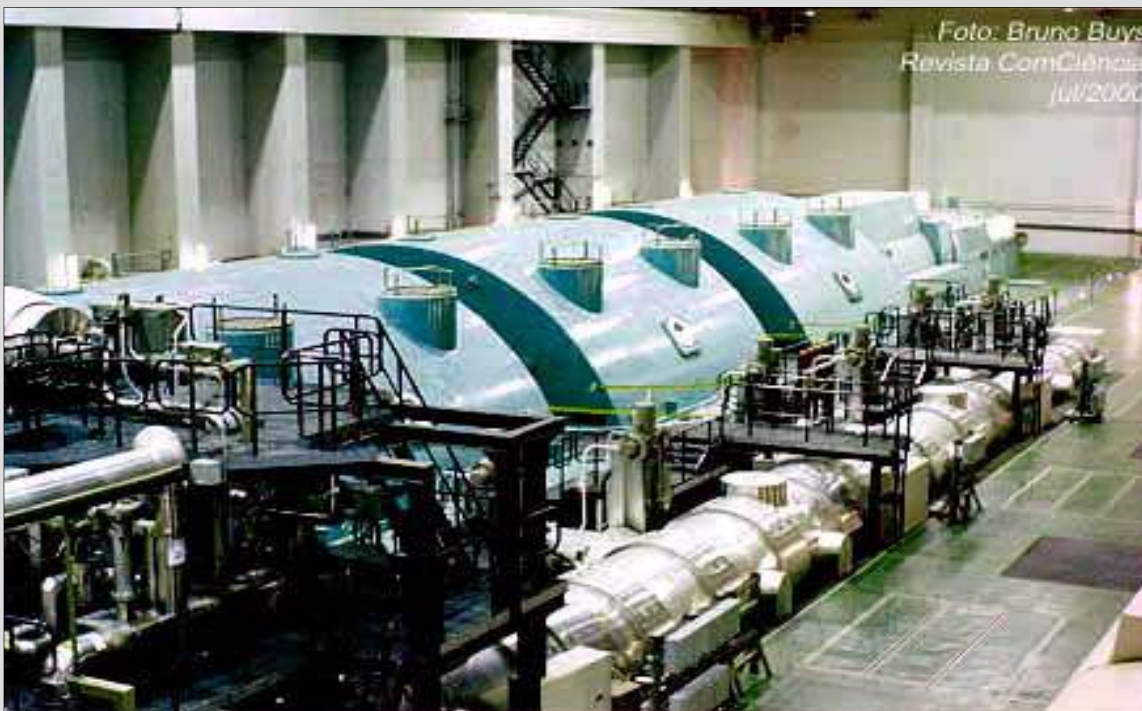
Vista interna da Usina Angra 2
