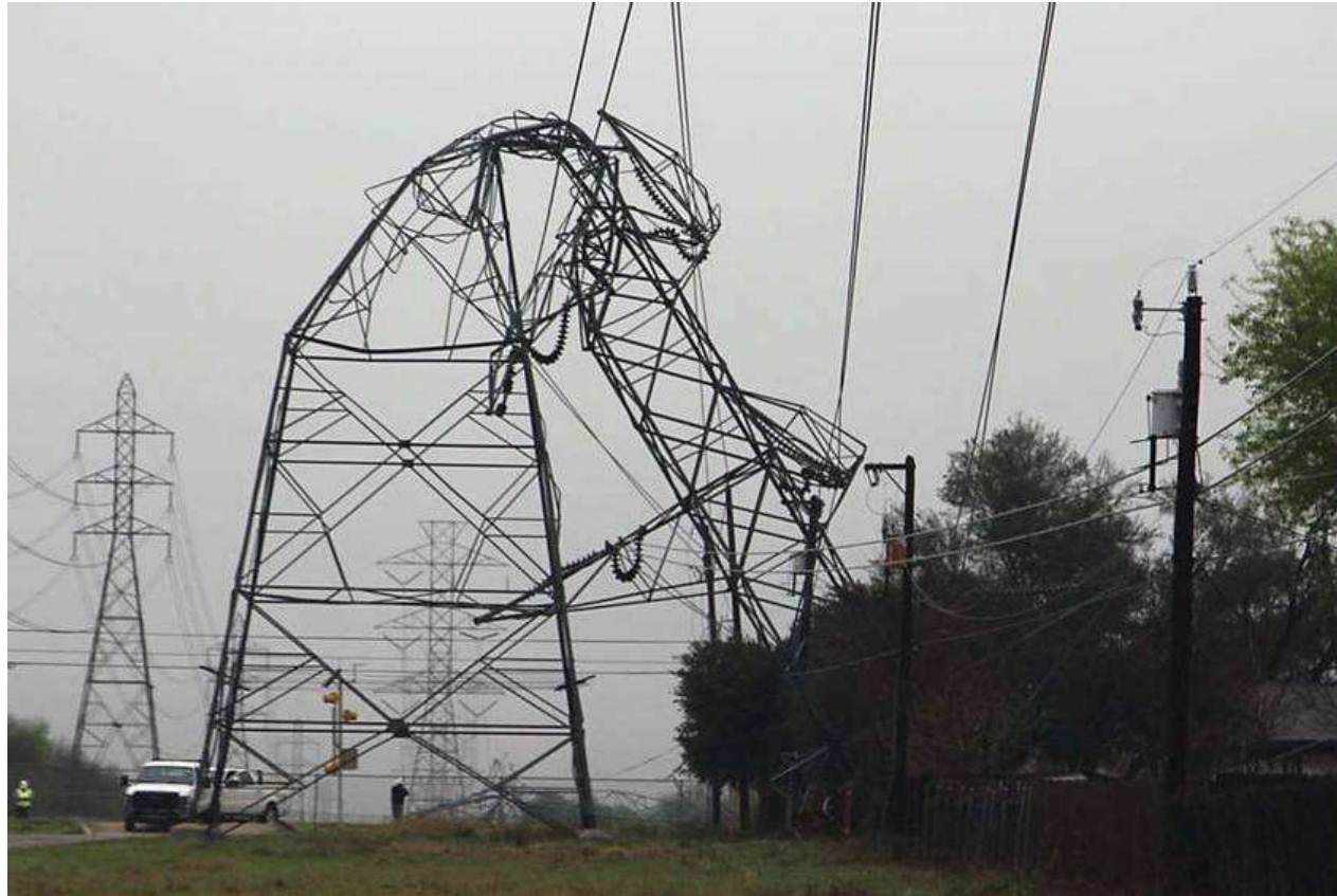
Fig.4: Falha de uma torre de transmissão por instabilidade estrutural pela ação do vento [4].
