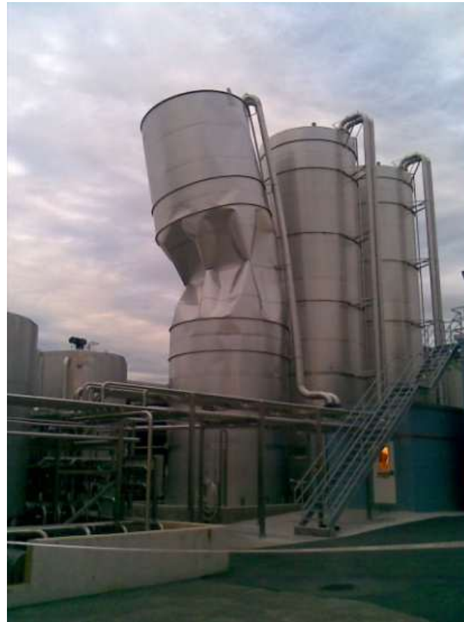
Fig.1: Instabilidade estrutural de um tanque cilíndrico pela formação acidental de vácuo interno [1]
