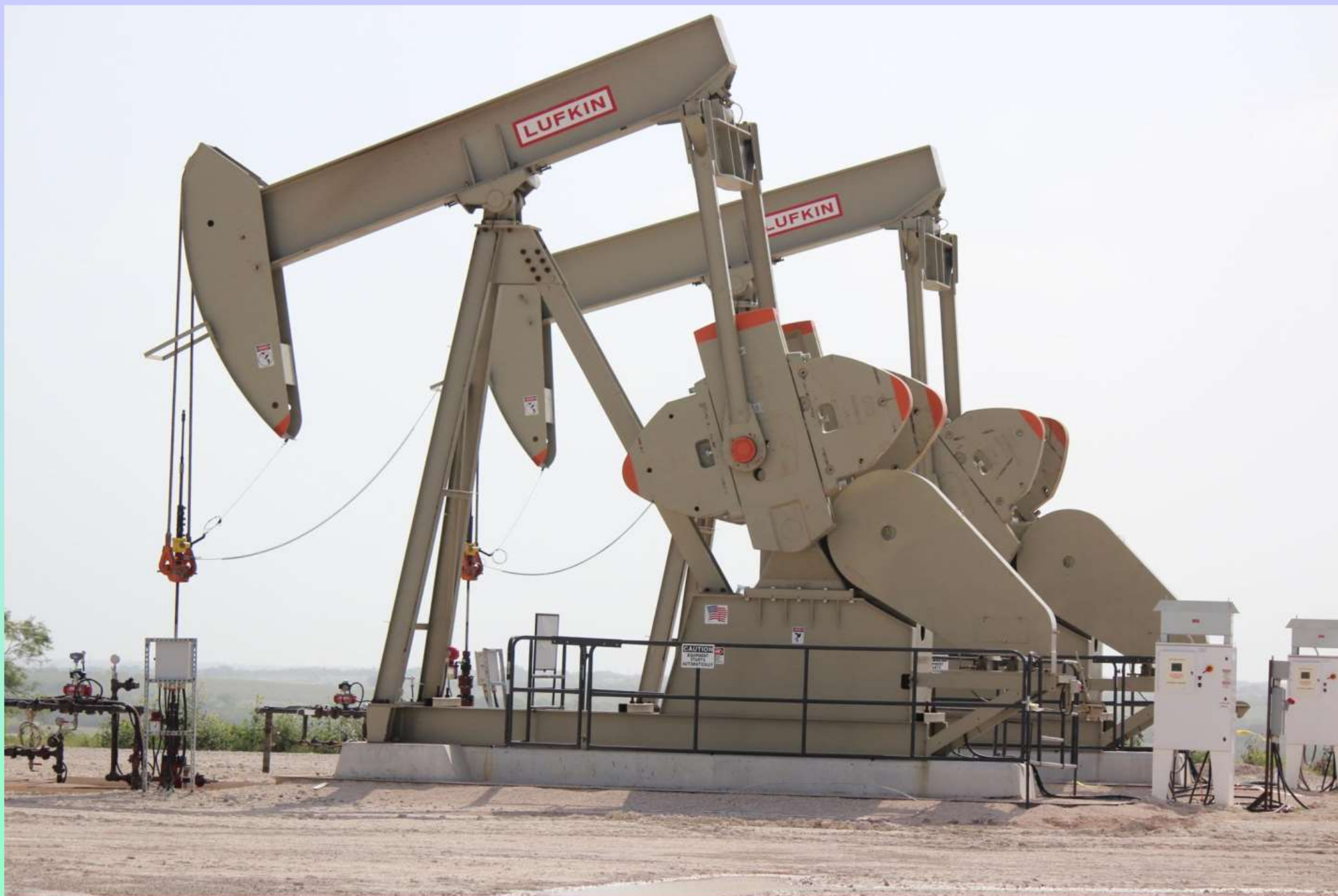
Poços de Petróleo em atividade – Kenedy-Texas
