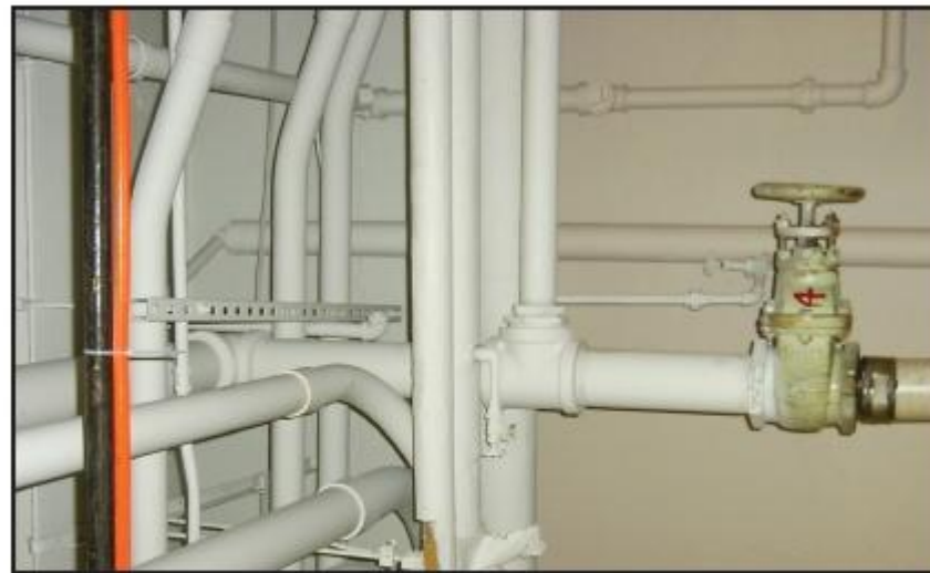
Tubulações e encanamentos
