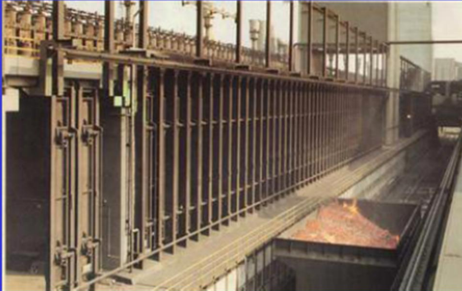
Típica Bateria de coqueificação
