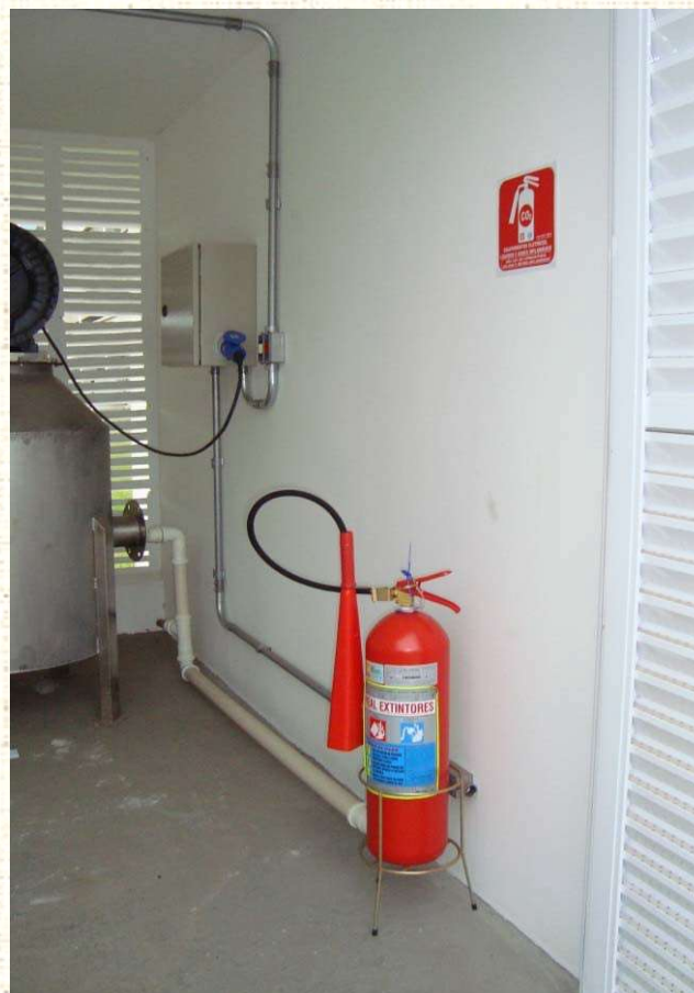
Abrigo Módulo Inicial B1 - todos tem exaustor e sinalização (Nov, 2015)
