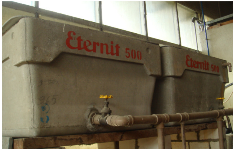
Figura 47: Caixas d'água de 500 litros
