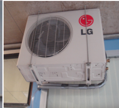
Figura 36: Aparelho no interior do prédio
