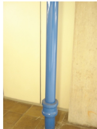
Figura 71: Um dos canos azuis, presentes em grande quantidade nos corredores do prédio. Eles captam as águas provenientes das chuvas e as conduzem ao esgoto.
