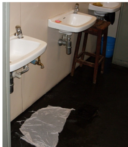
Figura 55: Vazamento em uma das pias do banheiro
