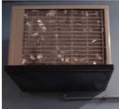
Figura 35: Aparelho no interior do prédio
