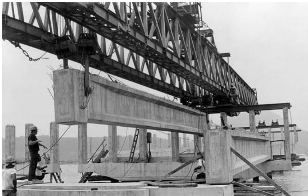
Figura 56 – Viga sendo posicionada na travessa de apoio. Observar o contraventamento após posicionamento.
