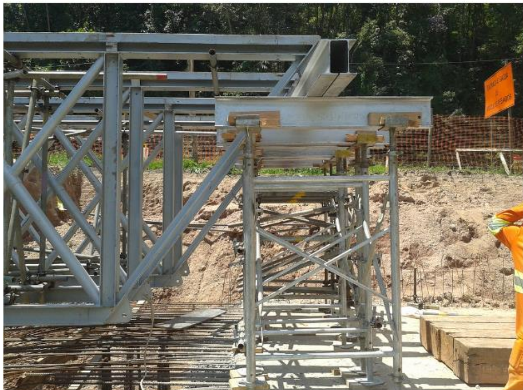
Figura 52 – Treliça horizontal de cimbramento
