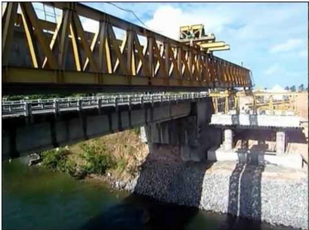
Figura 55 – Treliça posicionada para lançamento. Observar na parte superior uma ponte das duas pontes rolantes que transportam a viga.
