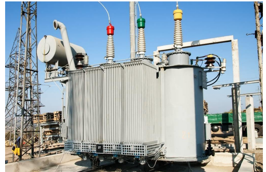
Transformador de subestação (rebaixador)
