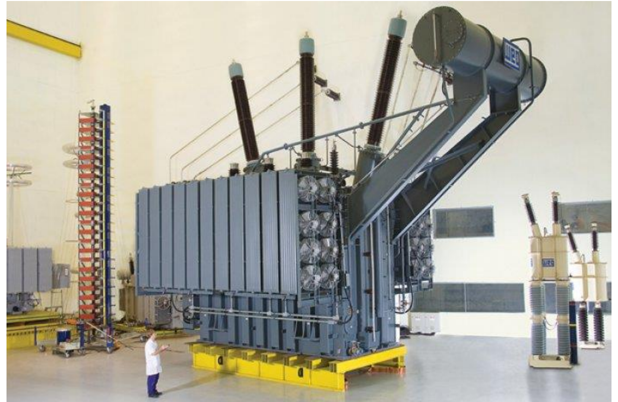
Aspectos Construtivos dos Transformadores de Potência
