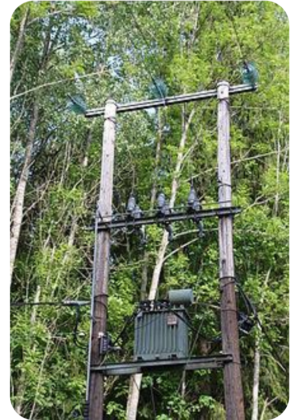
Transformador de distribuição trifásico de 23kV/240V
