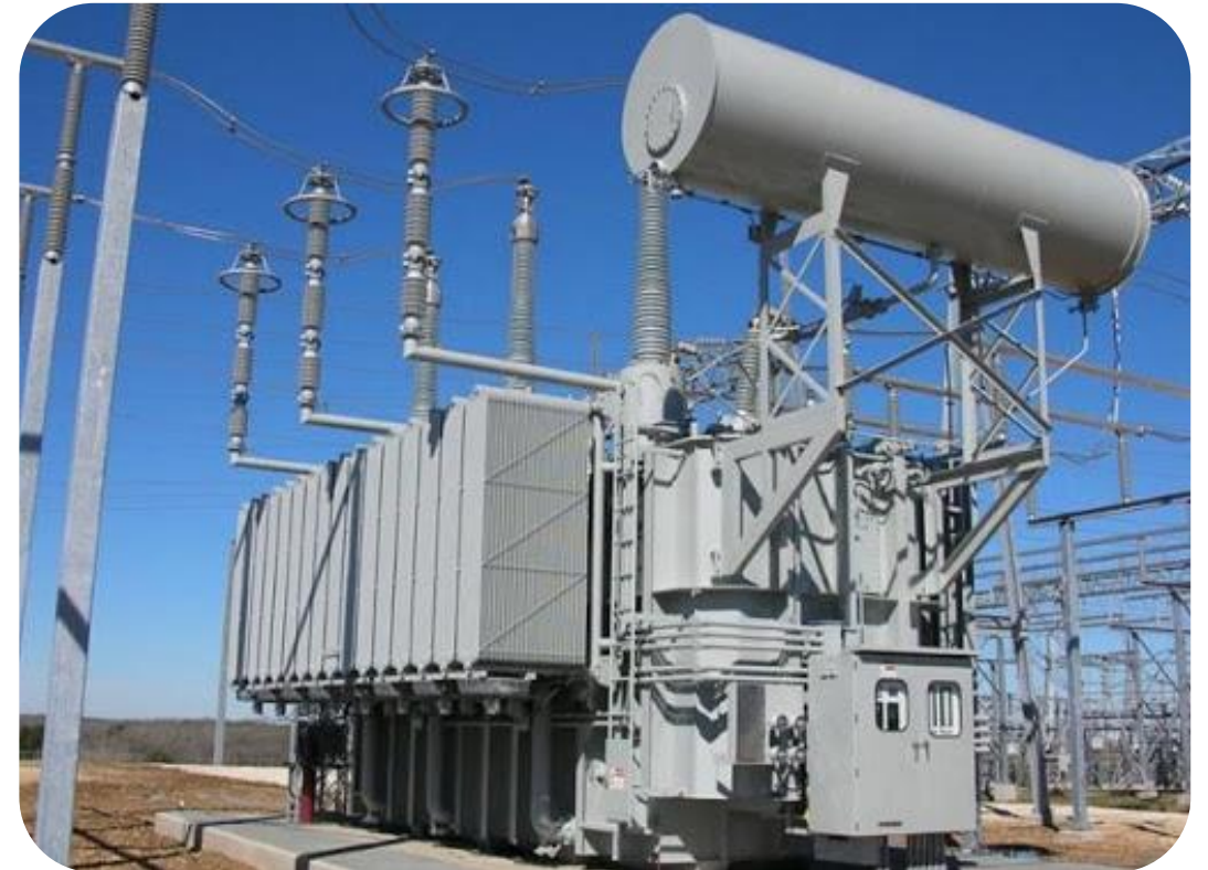
Transformador de potência (força)
