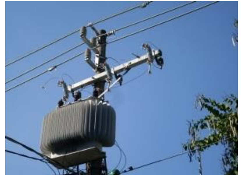
Transformador de distribuição
