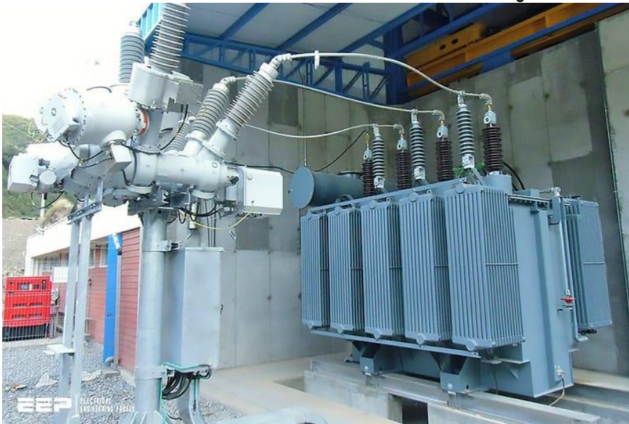
Transformador de geração (elevador)
