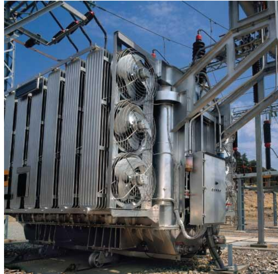
Aspectos Construtivos dos Transformadores de Potência
