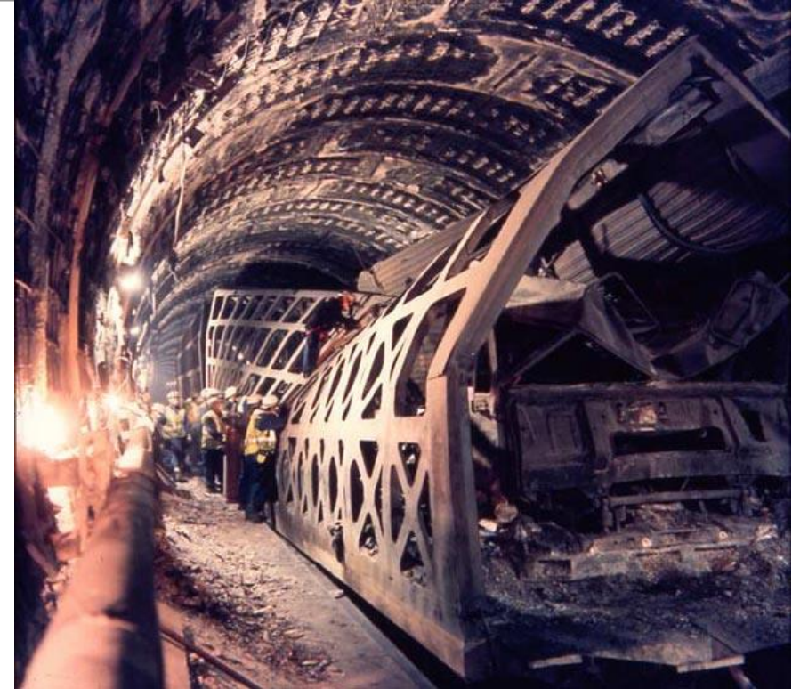
Eurotúnel após incêndio de 1996 (TunnelTalk, 2010)
