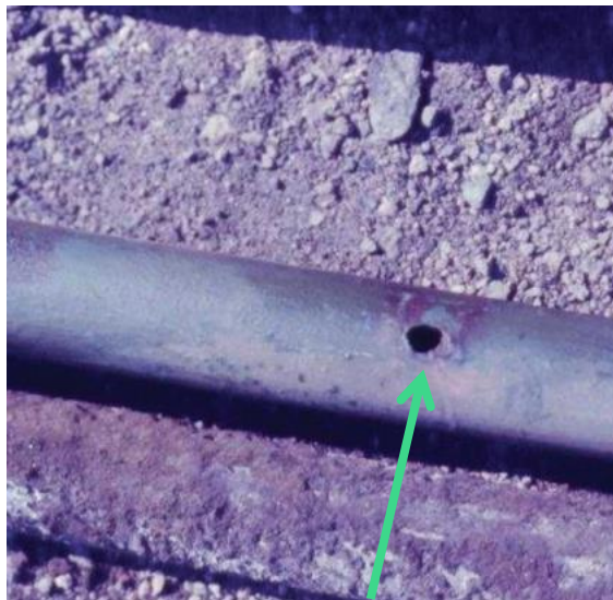
Oleoduto perfurado por correntes de fuga
