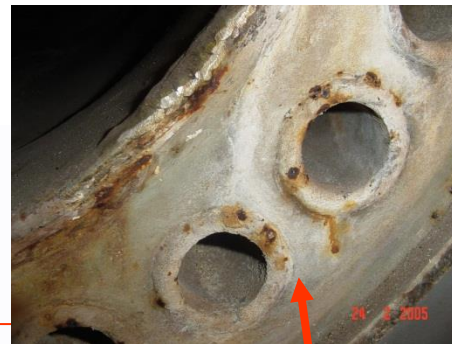
Pites próximos à solda - aço 304 barco AMB
