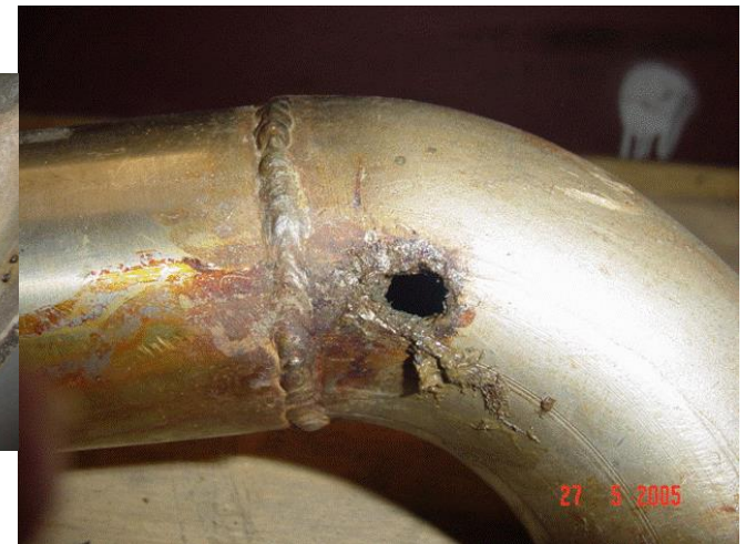
Corrosão em fresta próximo à solda em aço inox 304
