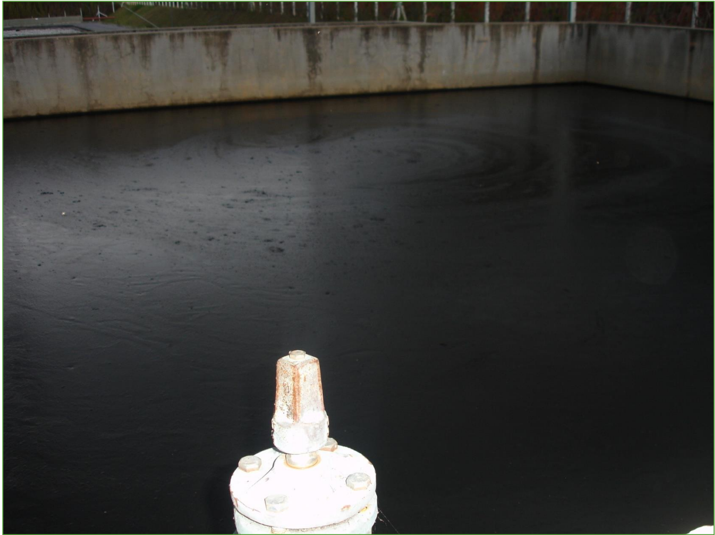
Primeiro tanque – com lodo
