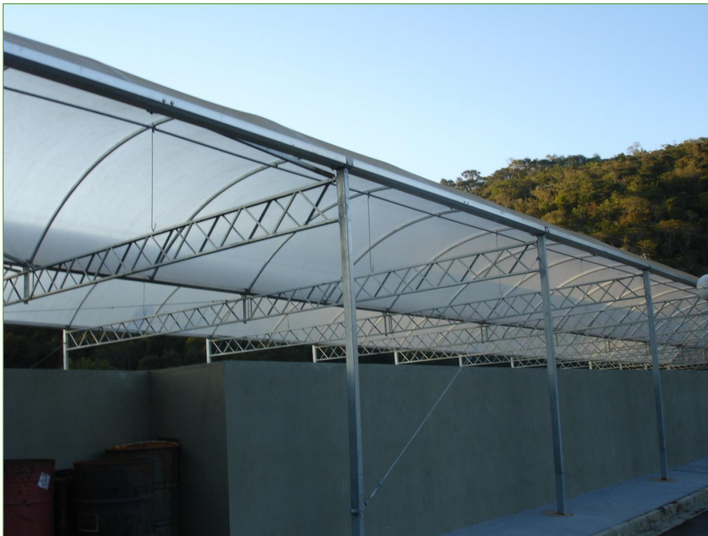
Cobertura do leito de secagem
