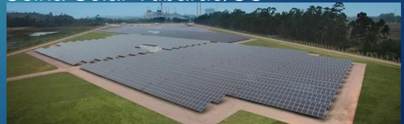
Usina Solar Tubarão/SC
