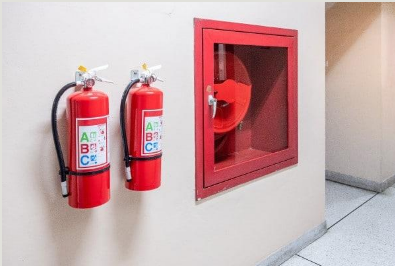
Extintores e hidrantes
